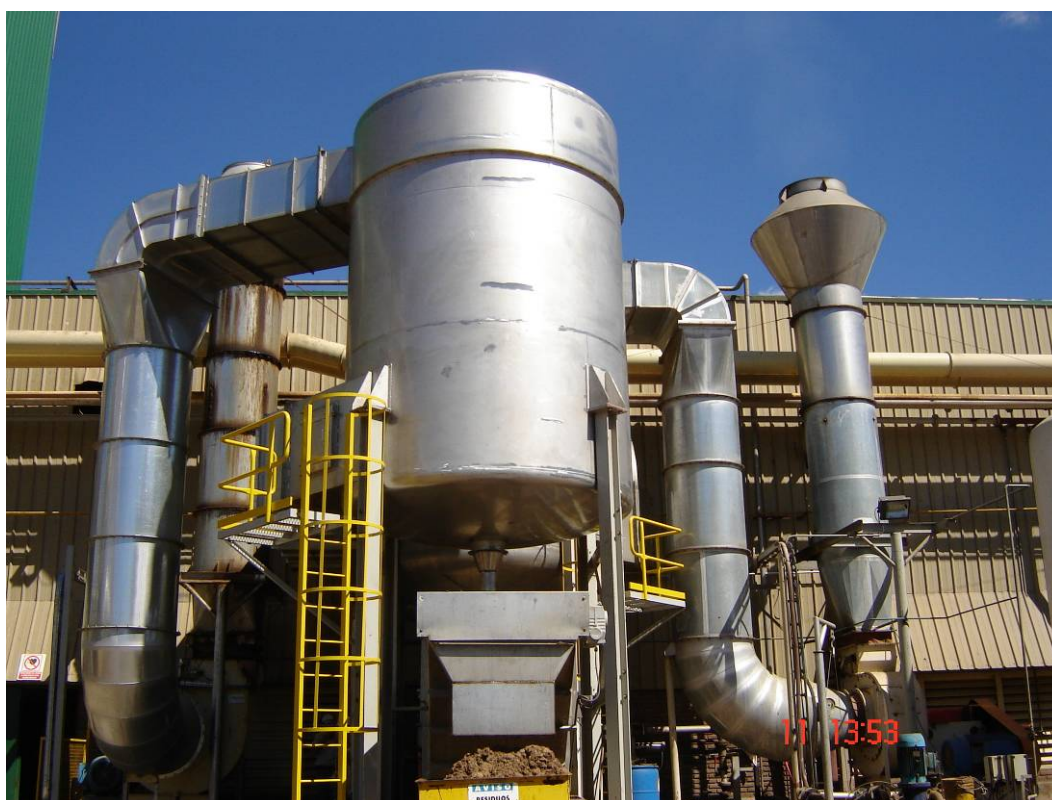
Aspiración de Vahos Salida de Prensa Continua Industria Maderera – Fabrica de Tableros Aglomerados y MDF
